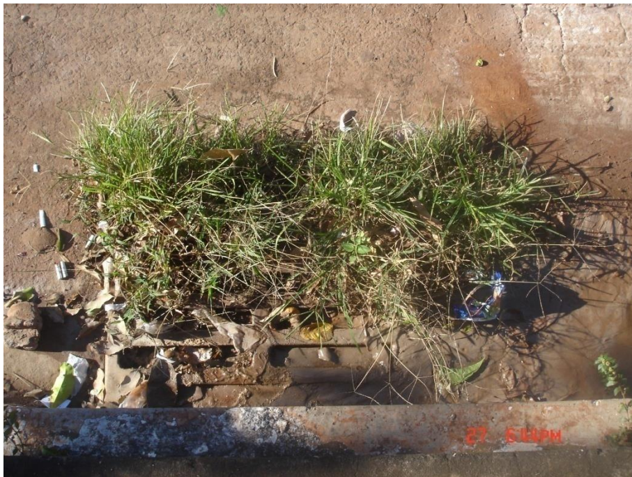
"Boca de lobo" entupida
