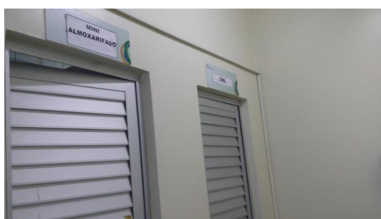
Figura 11: Material de limpeza, depósito..
