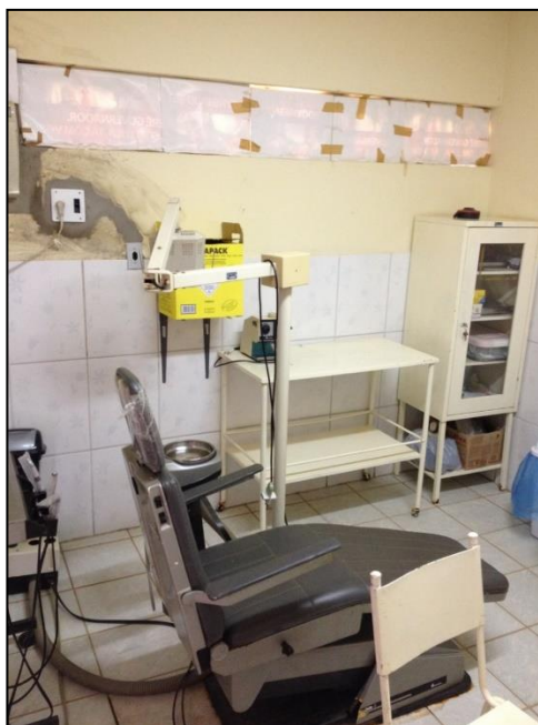
Figura 5: Unidade básica de saúde Isaías Domingos de Queiroz (“Posto de saúde de Tanquinhos”) – Consultório médico – vista 3 – cadeira do dentista (consultório compartilhado).
